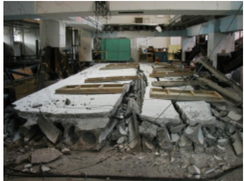
(d) Collapsed floor units
